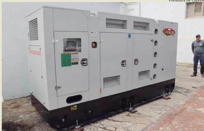
Novo gerador já foi instalado no hospital
