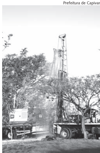
Poço perfurado fica na ETA 2, na avenida Ênio Pires de Camargo
